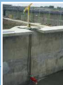
Installazione di miscelatore sommerso tipo MX-GIR con struttura di sollevamento. Installation of a submersible mixer type MX-GIR with lifting system.
