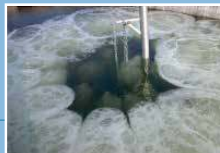
Fasi di avviamento di aeratore sommerso radiale. Starting stages of a radial submersible aerator.
