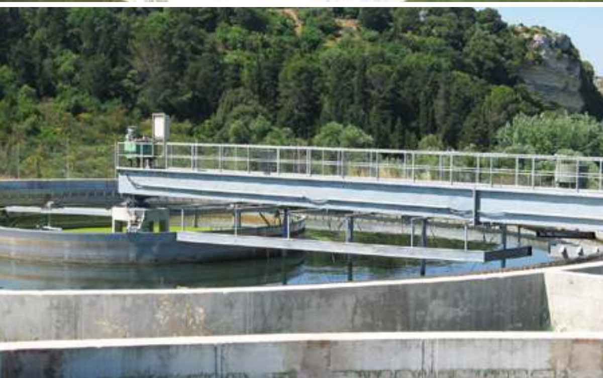
05-094 Chiariflocculatore a trazione periferica con agitatori a cancello centrale.
