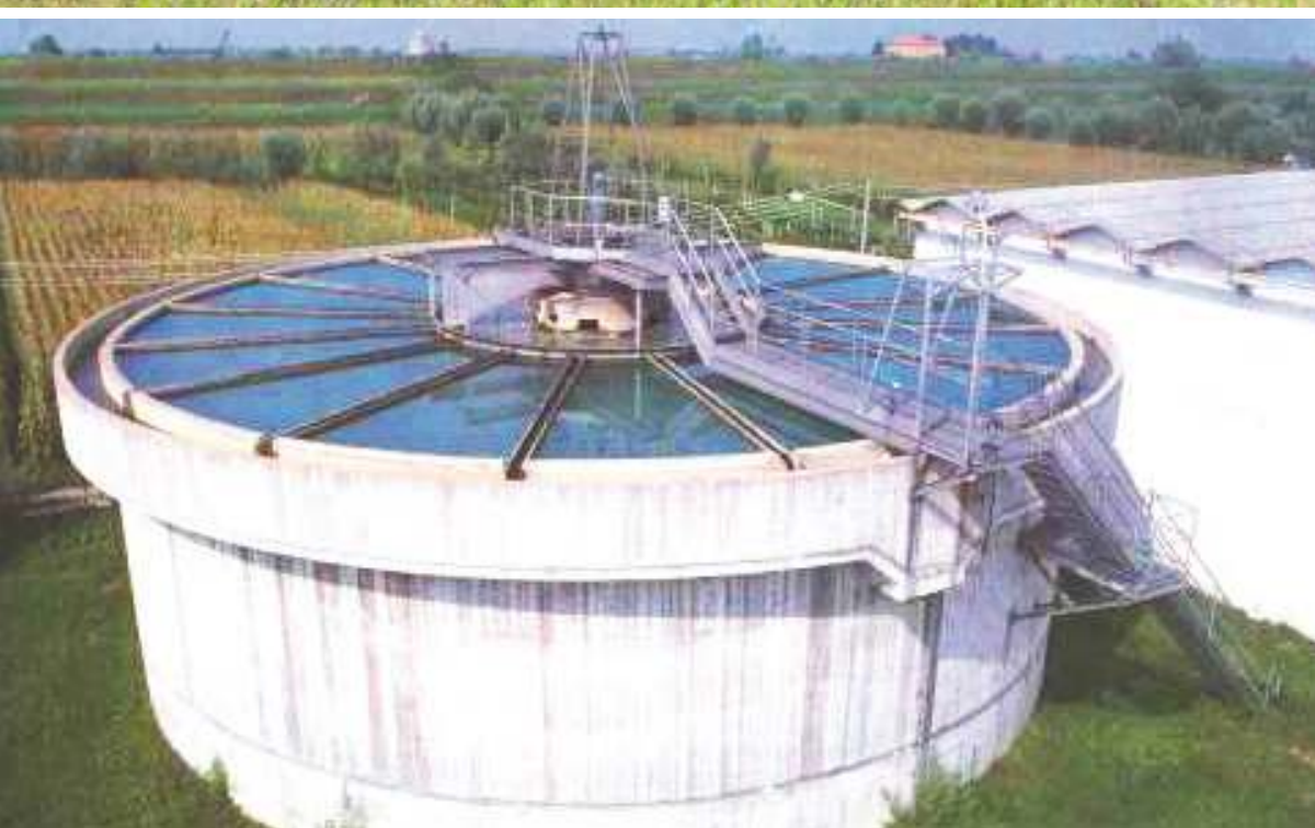
05-094 Chiariflocculatore a trazione centrale per impianto di potabilizzazione.
